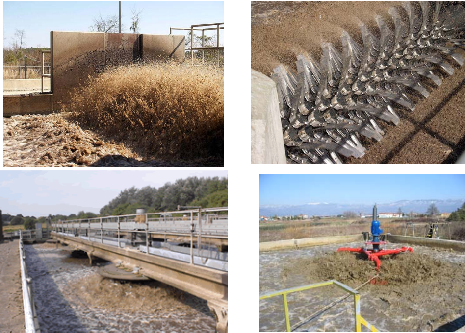
Figura 2: Aireación superficial de aguas residuales con aireadores tipo cepillo y aireadores tipo turbina.
