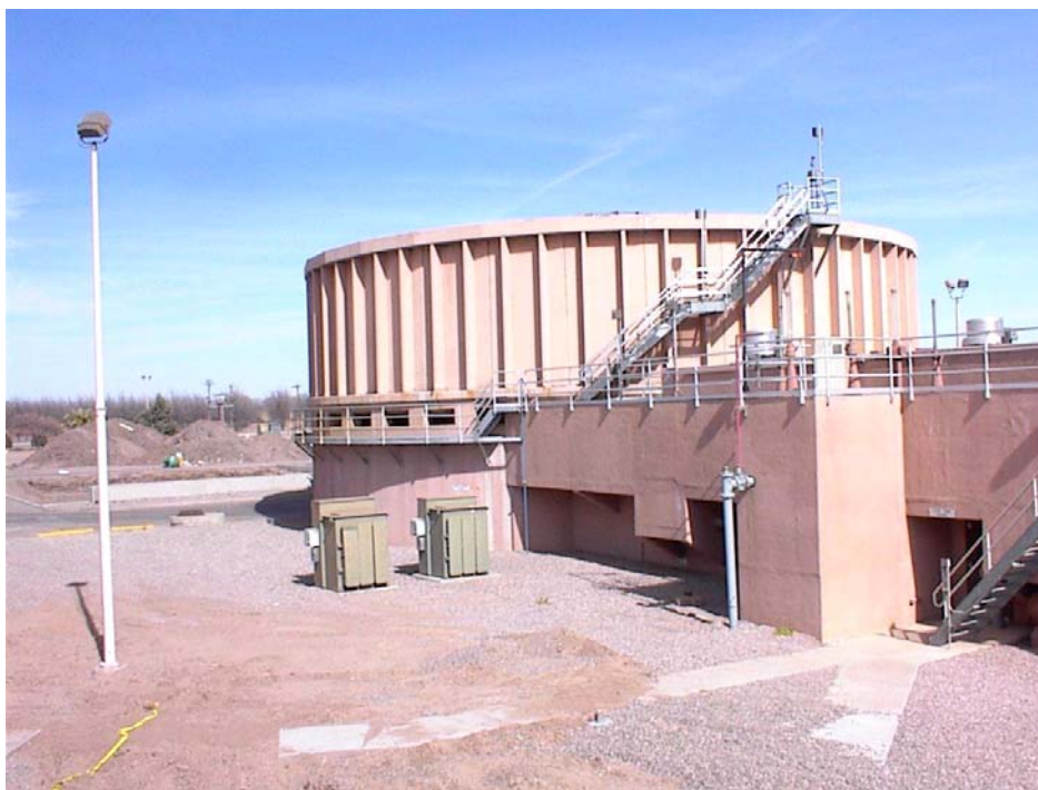
Figura 4: Biofiltro sintético para tratamiento de aguas residuales..
