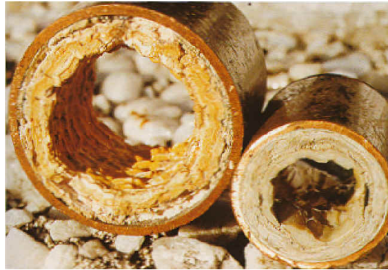
Figura 1: Formación de precipitados en tubos y accesorios de las calderas por la presencia de dureza en el agua.
