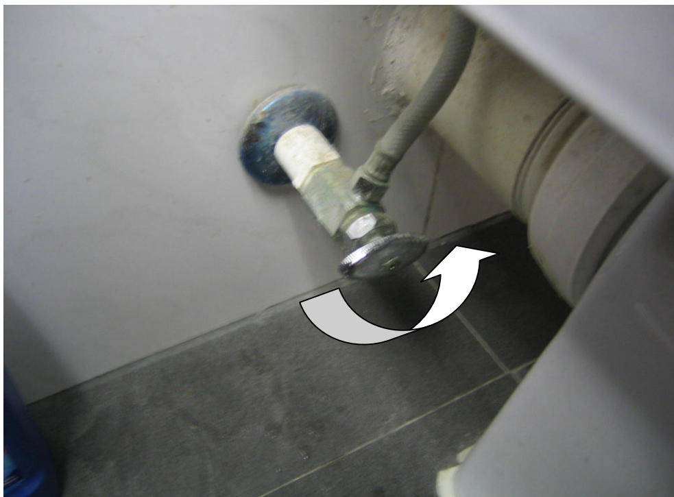
圖 10) 固定波曲後，可以逆時針方向重新開放入水閘掣(座廁後)，以讓沖廁水注入水箱。
