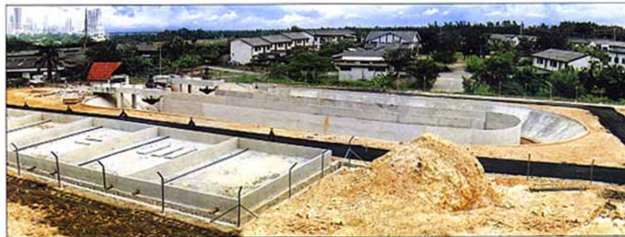
吉隆坡 JBT Kramat 3500人口之氧化沟生活及处理厂 JBT Kramat, Kuala Lumpur 9,500 PE Oxidation Ditch S.T.P
