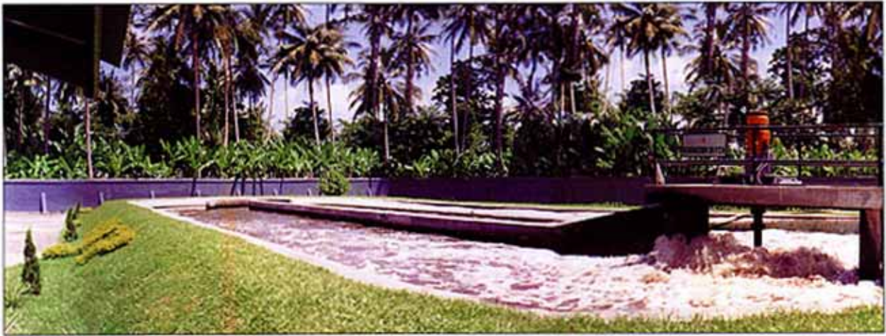
棉兰 PT Multi Bintang 可口可乐及啤酒厂 300 m 3 /日 氧化沟污水处理厂 PT Multi Bintang, Medan Coca-Cola & Brewery Plant 300m 3 /D Oxidation Ditch.
